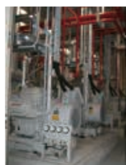
アンモニアとCO 2 を併用した冷凍機
